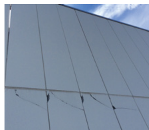
留付部クラック（外部側）
