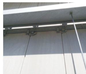
留付部クラック（内部側）
