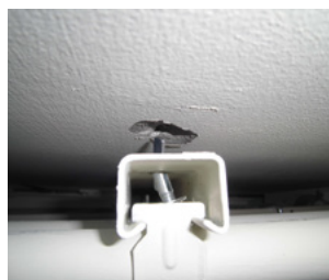
ハンガーレールでの破損例2
