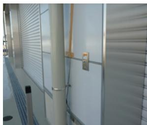
横張り工法での短手クラック
