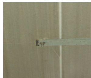
金物取り付けによるクラック
