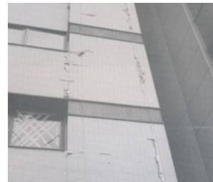
横張り工法での不具合
