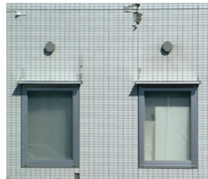
縦張り工法での不具合
