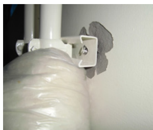
ハンガーレールでの破損例1
