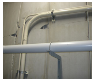
配管取り付けによるクラック
