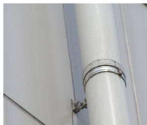
縦張り工法での長手クラック
